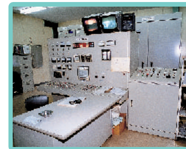
制御システム
